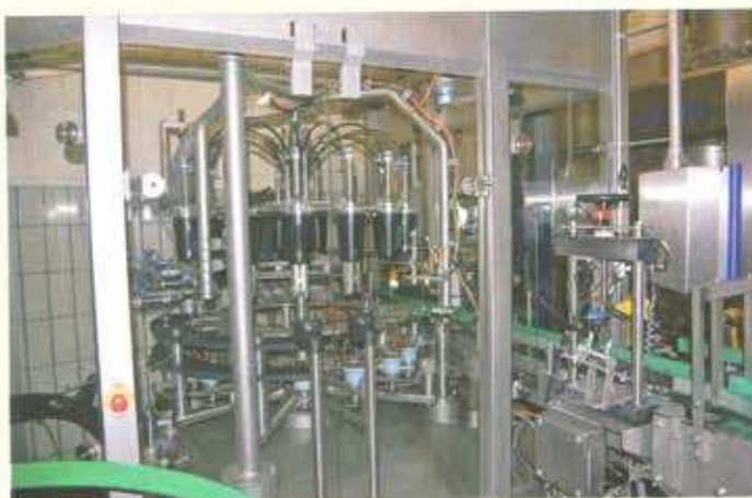
12 000 Bügelverschlussflaschen verschließt der neue Verschließer in Korschenbroich
